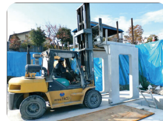
雨水地下貯留槽（三島町公園調整池）
