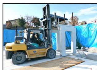
■ 雨水地下貯留槽 （三島町公園調整池）
